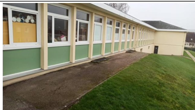
015 : Allèges fibres ciment Toilettes, Jeux, WC, remise, réfectoire primaire
